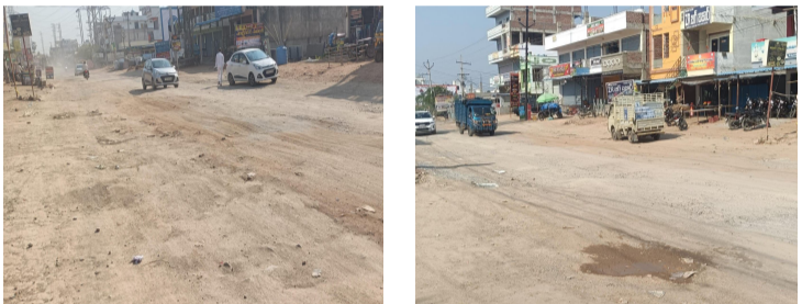
వార్తాపత్రిక, మార్చి 26, (వార్తా పత్రిక) : చౌటుప్పల్ పట్టణ కేంద్రంలోని వలిగొండ రోడ్డు నిర్మాణం సరిగ్గా లేకపోవడంతో గుంతల మయంగా మారింది. ఈ రోడ్డులో ప్రయాణించే వాహనదారులు, పాదచారులు తీవ్ర ఇబ్బందులు పడుతున్నారు. రోడ్డులో ఉన్న గుంతల కారణంగా ప్రమాదాలు జరిగే అవకాశాలు ఎక్కువగా ఉన్నాయి అని ప్రజలు పేర్కొన్నారు. ప్రతి రోజు వందల సంఖ్యలో లారీలు, బస్సులు, ఆటోలు, ద్విచక్ర వాహనాలు రాకపోకలు సాగిస్తే ఈ మార్గం ఇప్పుడు ప్రమాదాల కేంద్రంగా మారడంతో వాహనదారులు భయంతో ప్రయాణిస్తున్నారు. వాహనానికి గుంతలను తప్పించుకునే ప్రయత్నంలో ఎదురుగా వస్తున్న వాహనాలతో ఢీకొని ప్రమాదాలు జరిగే అవకాశం ఉంది. ప్రత్యేకంగా ద్విచక్ర వాహనదారులు రాత్రివేళలో దీపాల వెలుతురు తక్కువగా ఉండడం వల్ల గుంతలు కనిపించక జారి పడే ప్రమాదం ఉంది. వాహనాలు గుంతల్లో ఇరుక్కుపోవడంతో గంటలకొద్దీ ట్రాఫిక్ జామ్ ఏర్పడుతుంది. ఉద్యోగులు, విద్యార్థులు సమయానికి గమ్యస్థానాలను చేరుకోలేక ఇబ్బంది పడుతున్నారు. రోడ్డు పక్కనే ఉన్న చిరు వ్యాపారులకు దుమ్ముదూలి తో తీవ్ర ఇబ్బందులు ఎదుర్కొంటున్నారు. మున్సిపల్ సిబ్బంది, స్థానిక కౌన్సిలర్ వెంటనే స్పందించి రోడ్డు పనులు వేగవంతంగా పూర్తి అయ్యేలా తగిన చర్యలు తీసుకోవాలని అన్నారు
